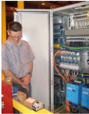
Techniker vor Inverterschrank
